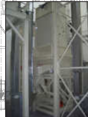
torre di raffreddamento
